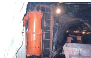
160kW矿用立泵 现场排沙照片
