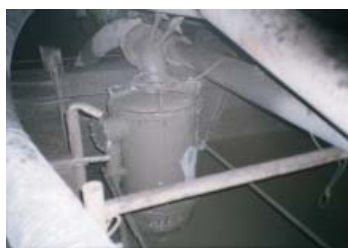
马鹿箐隧道 矿用立泵工作场景
