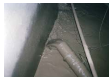
马鹿箐隧道 直径200mm排水管涌出干稠泥浆
