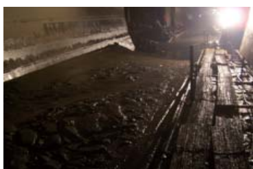
马鹿箐隧道 事故现场泥浆干稠
